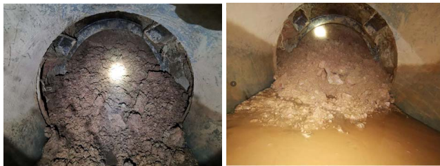
图一 顶管前方土体坍塌情况
