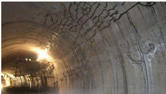
图1 某地铁车站混凝土裂缝局部图
