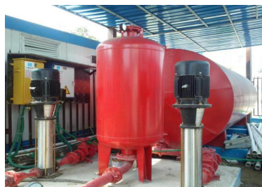
工具式变频水泵供水系统
