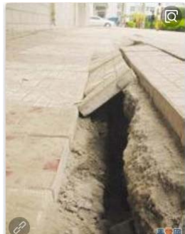
图1 公路沉降病害
