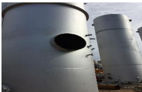
图1 水冷塔污氮气入口管道切割后未做防护
