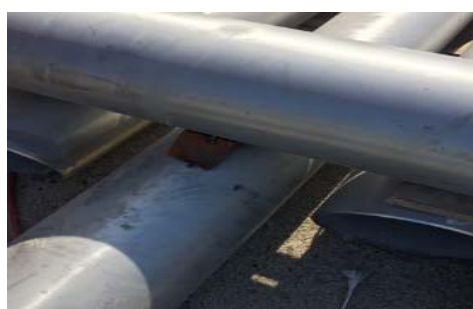
图2 碳钢角钢直接焊在不锈钢管道上
