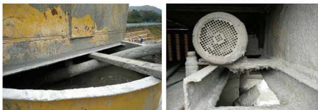
图7 储料罐及搅拌电机
