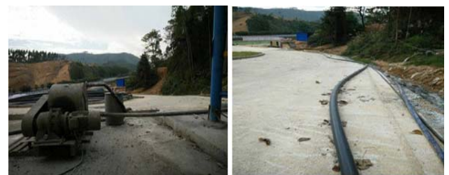
图3 软管泵及输送管道
