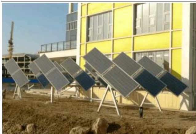
地面逐日光伏太阳能发电光板
