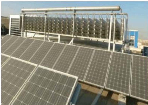
屋顶固定光伏太阳能发电光板
