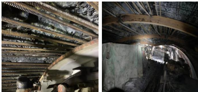
图1 顶拱拱架下沉变形
