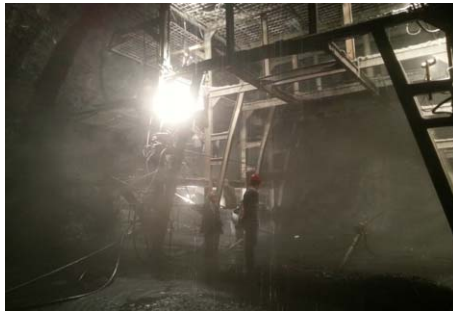
图2 隧道右洞洞内滴水
