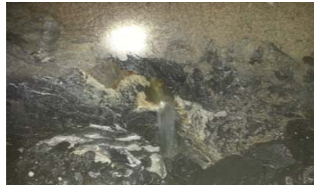
图1 隧道左洞洞内涌水
