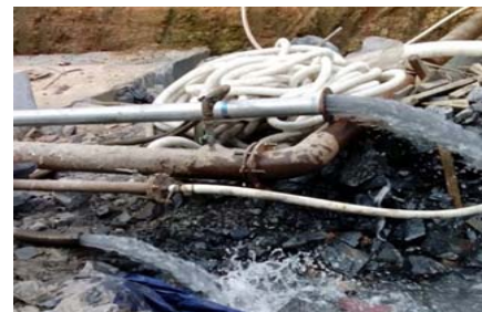
图3 暴雨过后排水现场
