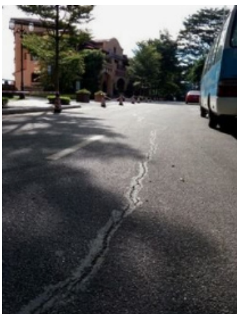
图1 沥青路面直线型开裂
