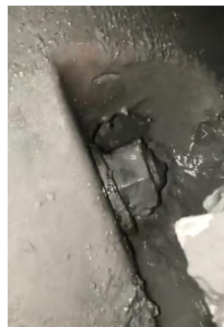
图3 管片破损位置渗漏水情况
