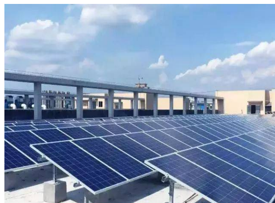
屋顶的太阳能光伏系统
