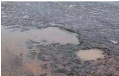
图3 因松散引起的坑槽
