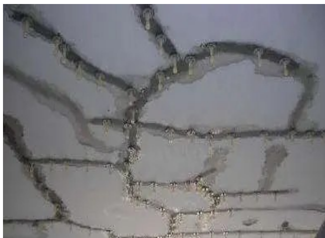
图1 地下室裂缝渗漏图
