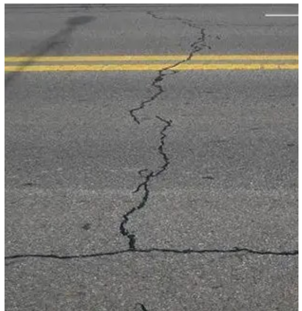
图1 沥青路面裂缝
