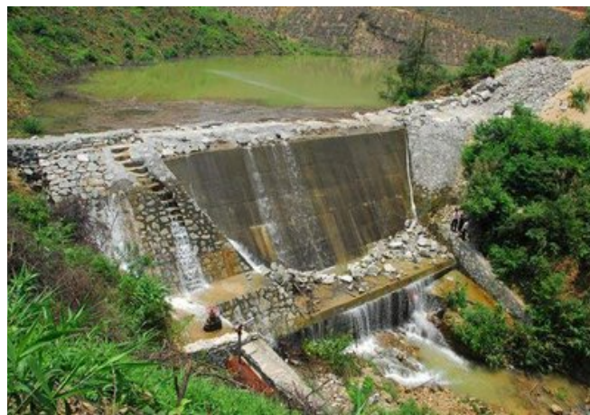
图1 大坝多处渗漏形成“喷泉”
