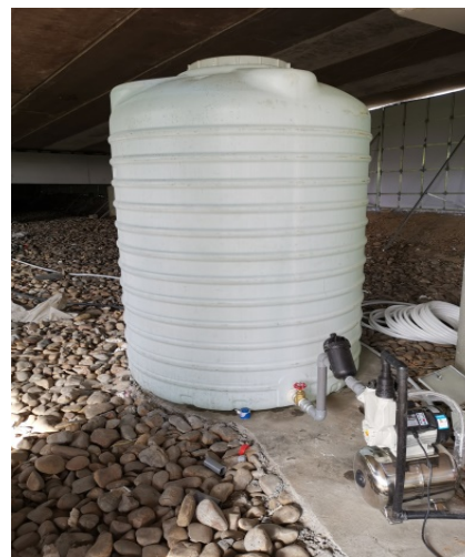
图4 桥下储水箱及加压泵
