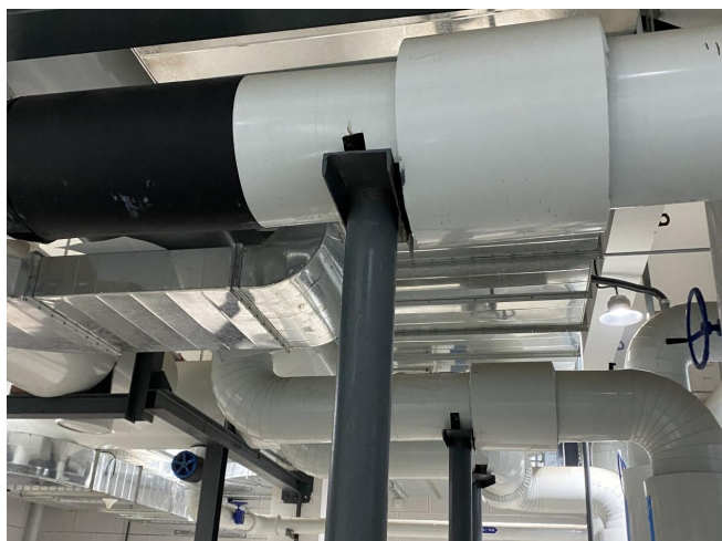
地下车库空调冷水管结露严重
