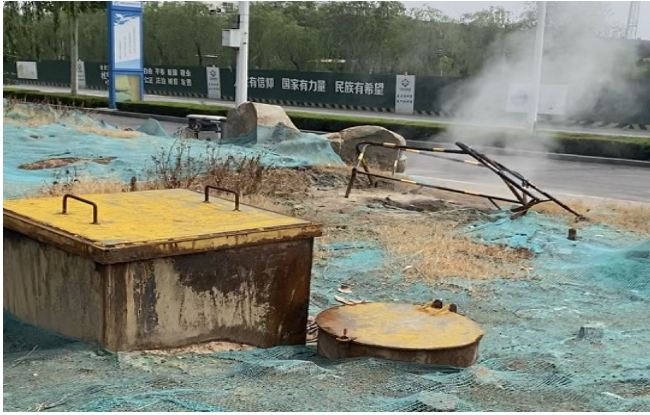
直埋热力管道保温破坏现场跑气严重
