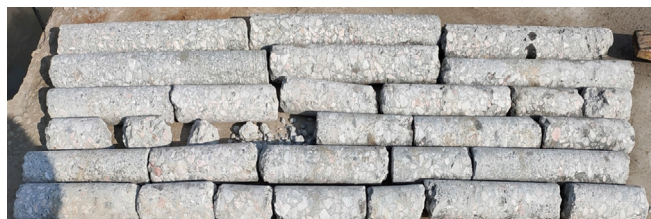
图2 注浆处理前抽芯图片
