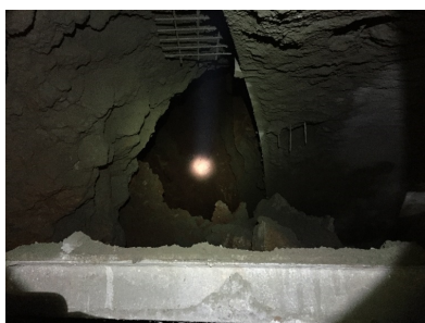
图3 白兆隧道右幅K8+533掌子面小型溶洞
