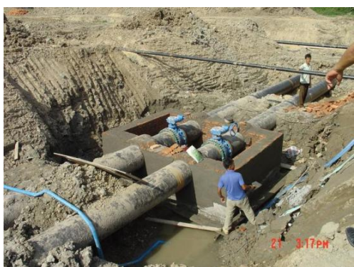
图1：市政给排水管道
