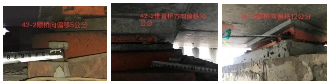
A匝道A42墩柱顶偏移现状实测图
