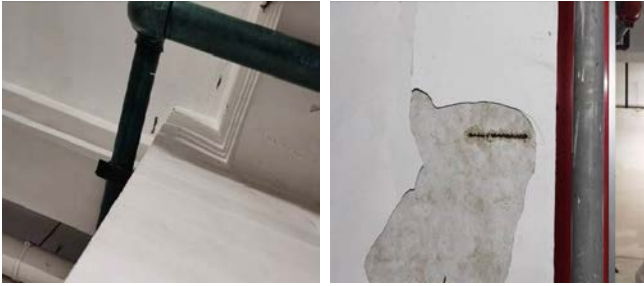
板混凝土保护层不足，钢筋锈蚀 柱混凝土保护层不足，钢筋锈蚀
