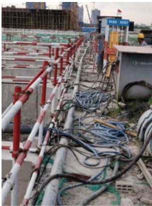
占用场地、管线盘杂、安全隐患
