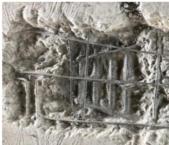
图3 梁板钢筋锈蚀情况图
