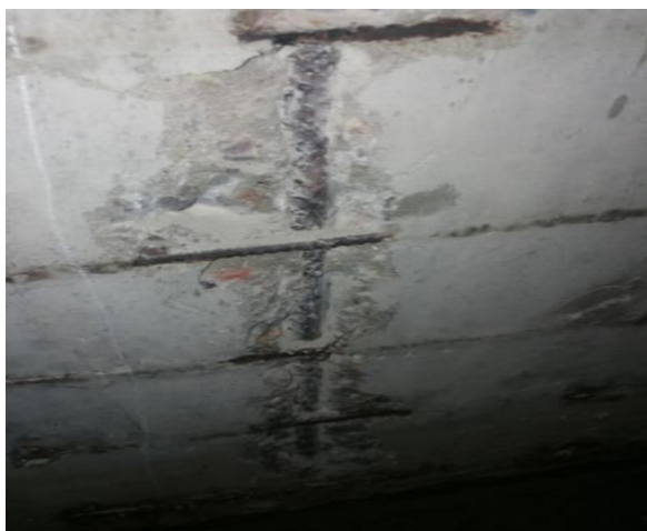
图2 柱子钢筋锈蚀情况图
