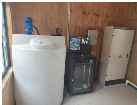
图5 现场设置的监控设施
