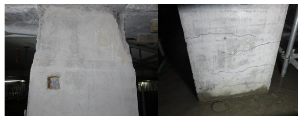
图4 地下室柱裂缝图
