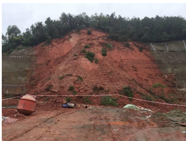
图4 滑坡整体失稳后正立面
