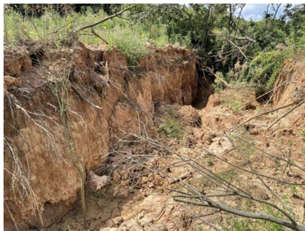
图 滑坡张裂缝（主裂缝）
