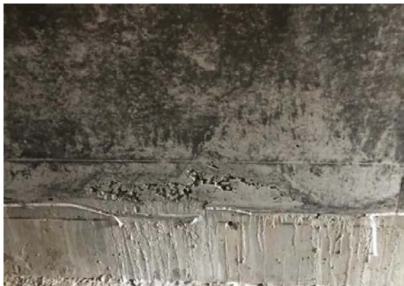
管廊混凝土色差、错台、蜂窝麻面
