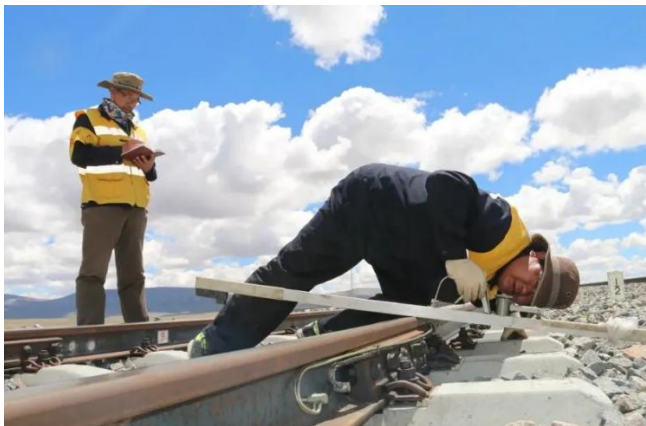
图3 铁路路基冻害检查
