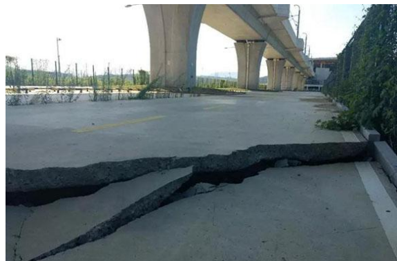
图2 地震引发的桥梁沉降
