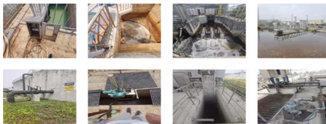
图4 现状设备情况
