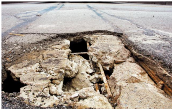
图2 道路桥梁剥蚀破坏现象
