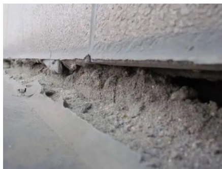
图1 道路桥梁地基沉降不均匀现象
