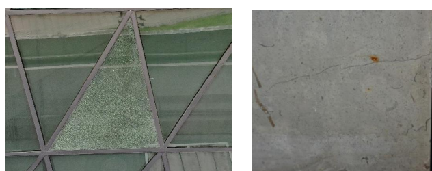
(a) 玻璃碎裂
