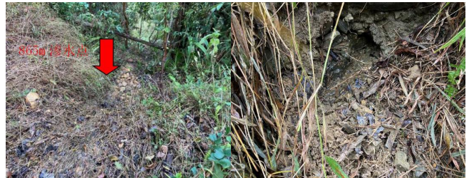
图2 溢洪道865~875m高程平台下游端斜坡S1渗水点
