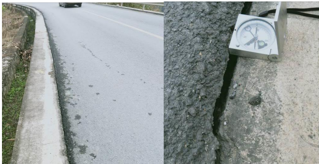
图1 S209道路内侧裂缝及其宽度
