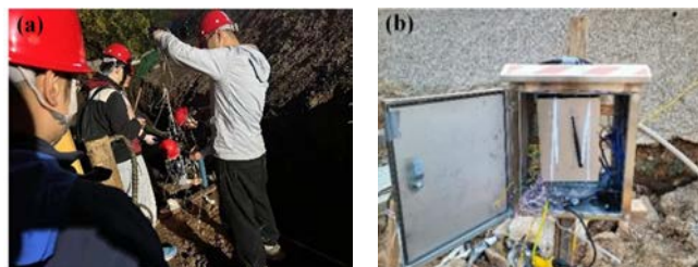
图5 光纤深层水平位移传感器与解调仪现场布置照片
