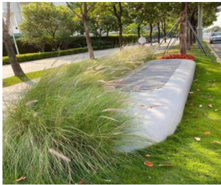
图4 环境友好型综合管廊通风节点实拍照片图
