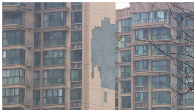
图1 墙体涂层脱落
