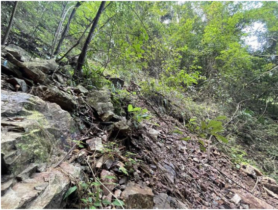
图2 崩塌B1侧视图
