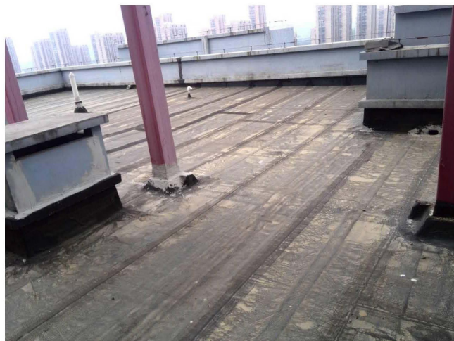
图1 建筑屋面防水现状
