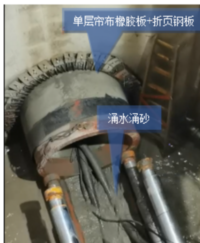
图3 某顶管掘进阶段洞门渗漏照片 间的环形间隙密封完全，如图4所示。
