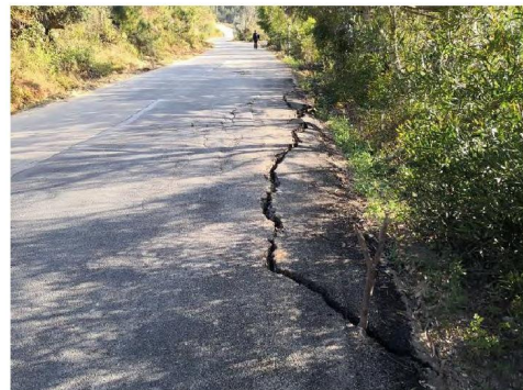
图1 道路路基塌陷问题
