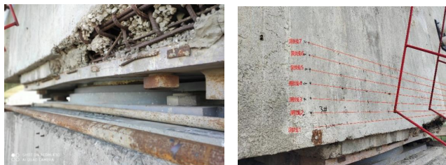
图1 0号块底板混凝土空洞、露筋 图2 弹性波CT法测线布置图
