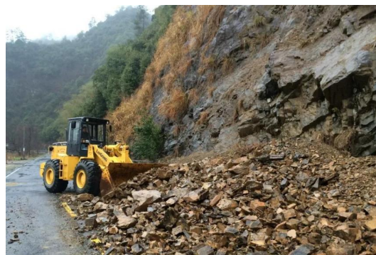
图2 崩塌碎落不良地质表面
