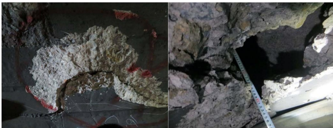
六盘山隧道 k238+821-828 拱顶衬砌压溃
