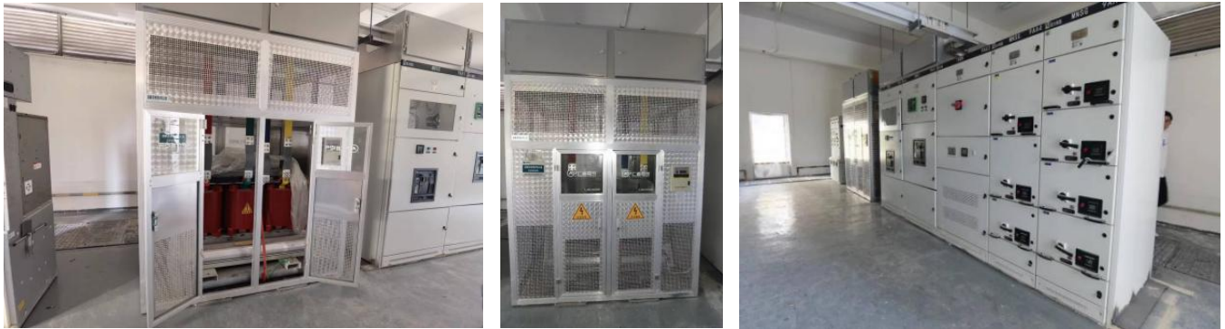
图1 变压器和开关设备
