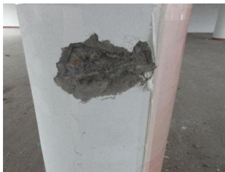
图4 钢筋间距过大照片
