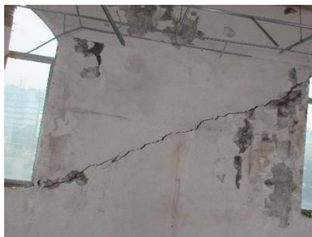
图3 墙体开裂照片
