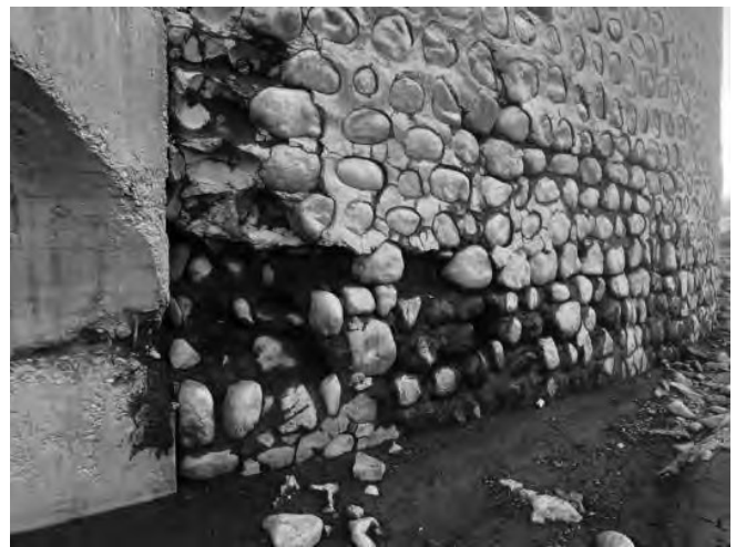
图2 枢纽前右裹锥底部安全隐患
