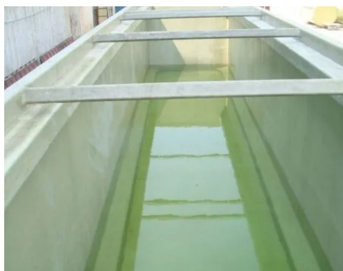
图1 污水厂构筑物水池
